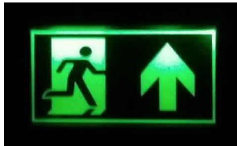
Figuur 2 Projectfoto vluchtrouteaanduiding in oplichtende toestand bij stroomuitval
